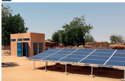
Installation dans la région de Maradi, au Niger
